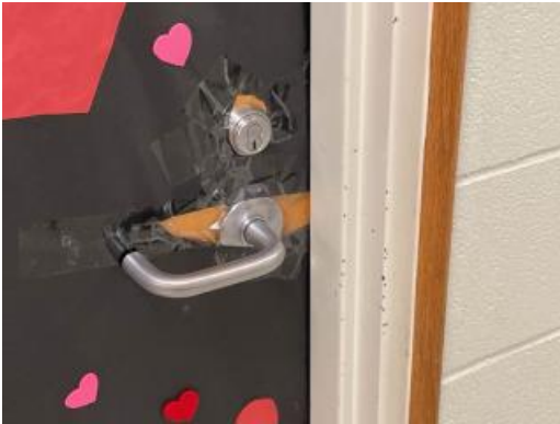
worn door entryway paint
