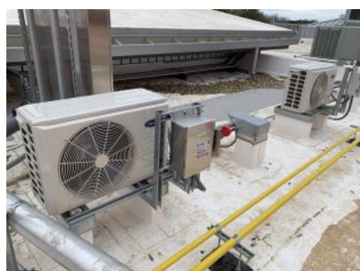
Rooftop fan system
