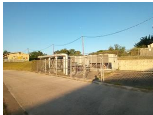
Exterior fan unit system
