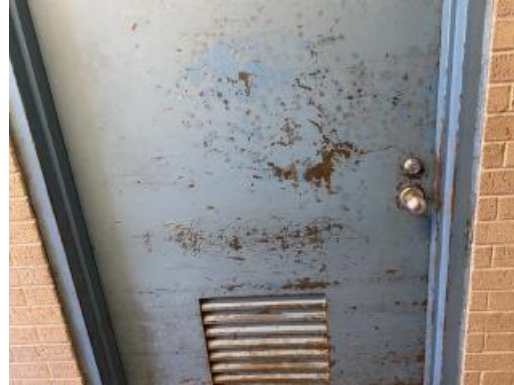
Rusted metal door
